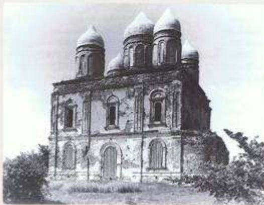
Троицкий собор Троицкого Оптина монастыря. Южный фасад. Вид до реставрации. Фото 80-х годов XX века.
